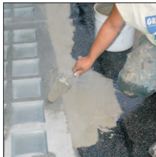
2. Assainissement des zones non solides et égalisation du support avec du Quellmörtelschnell .
